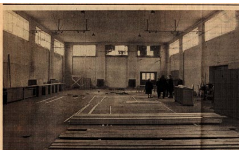
Der dickste Brocken, der im kommenden Jahr in Angriff genommen werden soll: die alte Turnhalle. Noch fehlt der Fußboden ganz, löckelt der Putz von den Wänden. Aber die Turnhalle wird dringend benötigt. BZ-Fotos: Harmut Rosen
